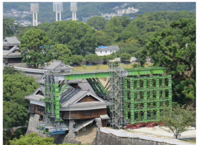
Manche Gebäude müssen von Gerüsten gestützt werden.
